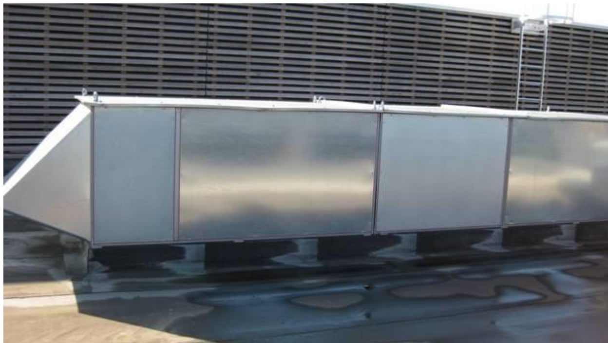
Voorbeeld balansventilatie: de luchtbehandelingskast op het dak van een schoolgebouw
